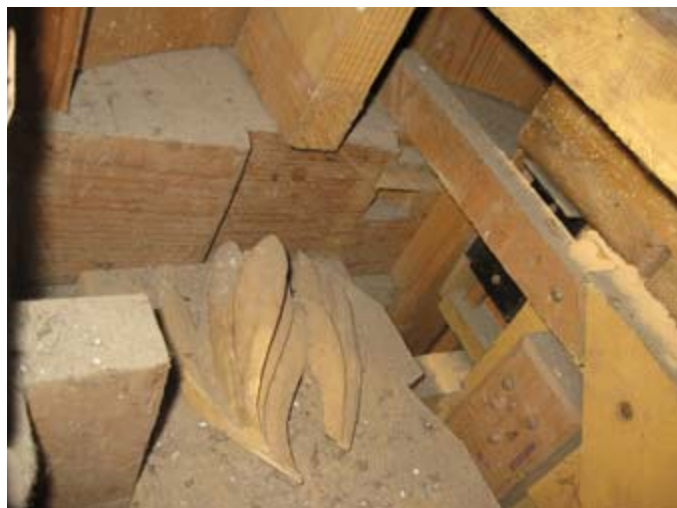
Die Orgel ist vom Holzwurm befallen
